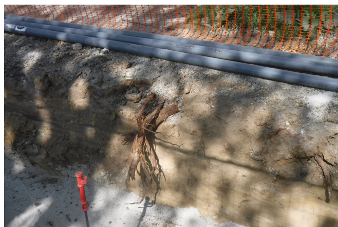
Dégâts sur racines (photo DRIAAF-SRAL)
